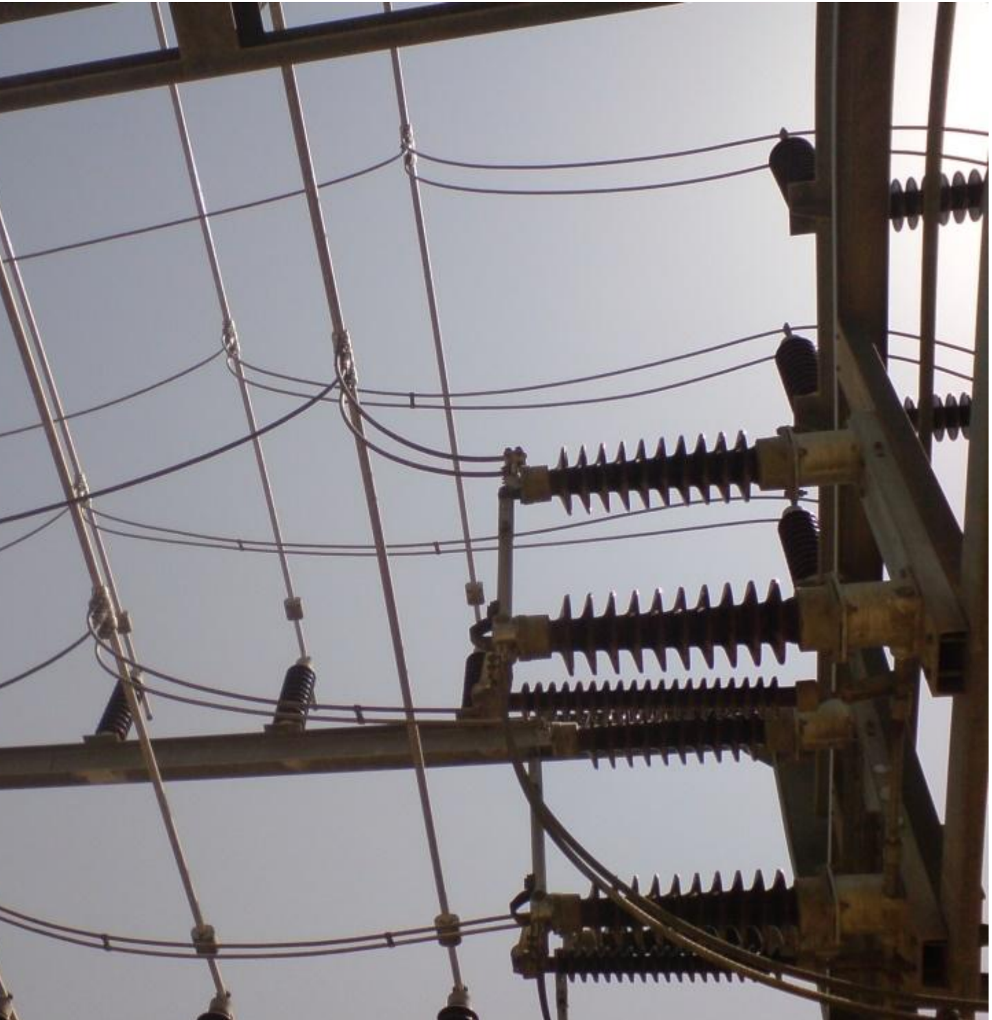
شینه بندی‌های پست: (Busbar)
